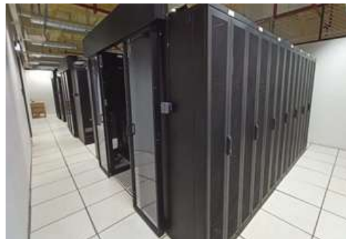
Gedung Setijadi (Ruang Server)
